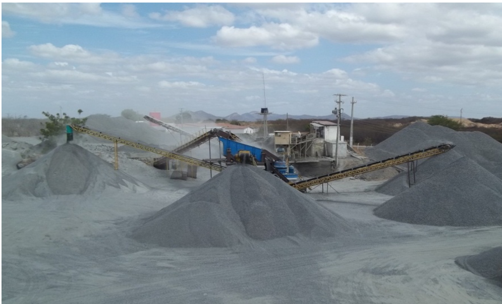
Figura 3 – Planta de britagem utilizada no projeto em estudo.
